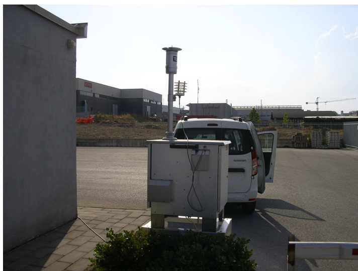
Figura 2. Centralina SKY-Post Tecora. Piazzale concessionaria AUDI
